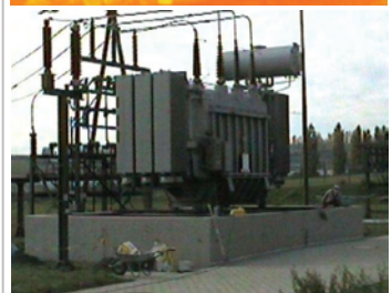
Transformator 110/10 kV, 16 MVA Normalbetrieb
