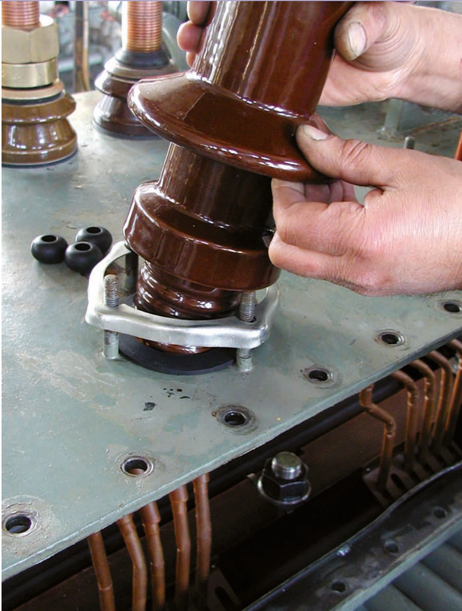
Dem Fehler auf der Spur: Spezialisten sorgen für ein langes Trafoleben.
